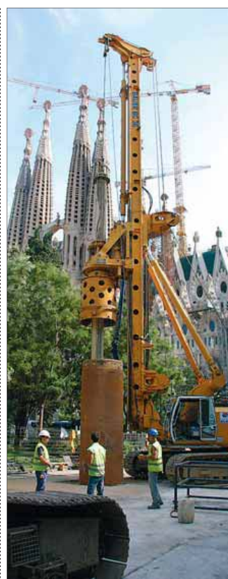
Un grup d'operaris a finals de juliol a l'inici de la construcció del mur ■ JORDI GARCIA
