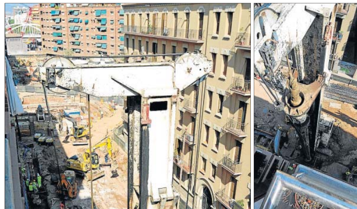
La máquina que provocó el accidente en un balcón de la calle Mallorca, junto a los edificios. NACHO MILLÁN/ACN
