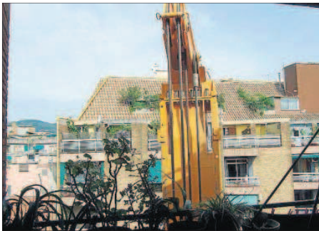
Las máquinas rozan los balcones del nº 226 de la calle Clot. AVE PEL LITORAL
